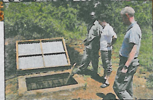
BIOGASS FRÅ GRIS: Frå biogassanlegget i Mara, Tanzania. Her vert det fylt på meir grisemøk. Fv. rektor Peter, Kirsten Markhus Underland og misjonær Frank Vorhaug. (Privat foto).
