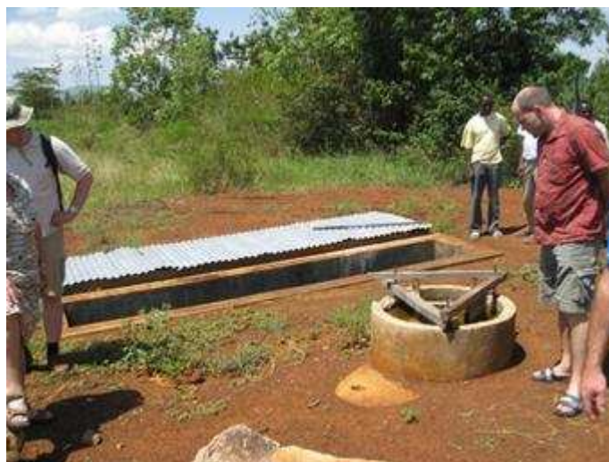
Mannlokk og utløps/ekspansjonstrau
